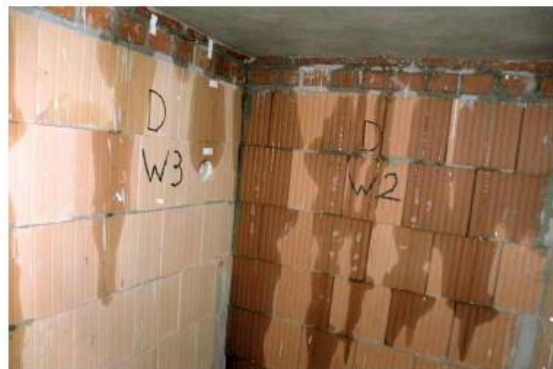
Abb. 10: Durchfeuchtung der Holzbalkeendecke
