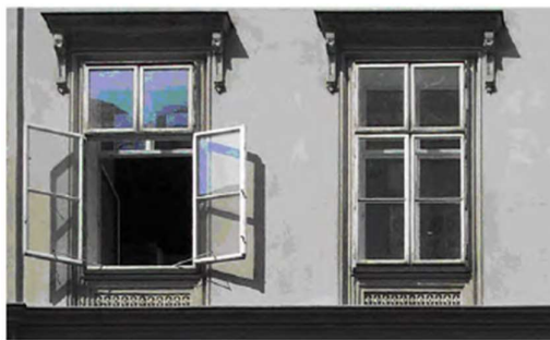
Abb. 31: Zustand vor der Sanierung 1985 (Quelle: Wiener Fenster. In: Stadtentwicklung und Stadtplanung. Hrsg.: MA 18. Wien 2014)
