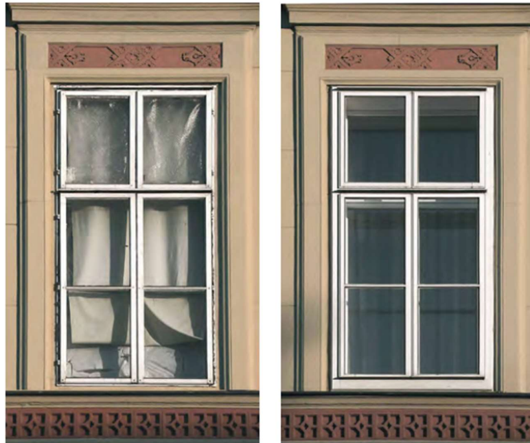
Abb. 37: Altwiener Kastenfenster – Vorher und Nachher (Quelle: Wiener Fenster. In: Stadtentwicklung und Stadtplanung. Hrsg.: MA 18. Wien 2014)
