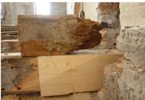
Abb. 44: Beschädigter Balkenkopf und Überblattung
